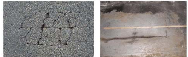
(a) 舗装の劣化 (b) デッキプレートのき裂 (舗装除去後に発見)
