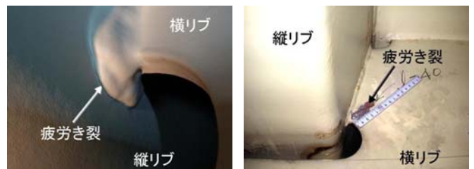
(a) 縦リブウェブのき裂 (b) 横リブウェブのき裂
