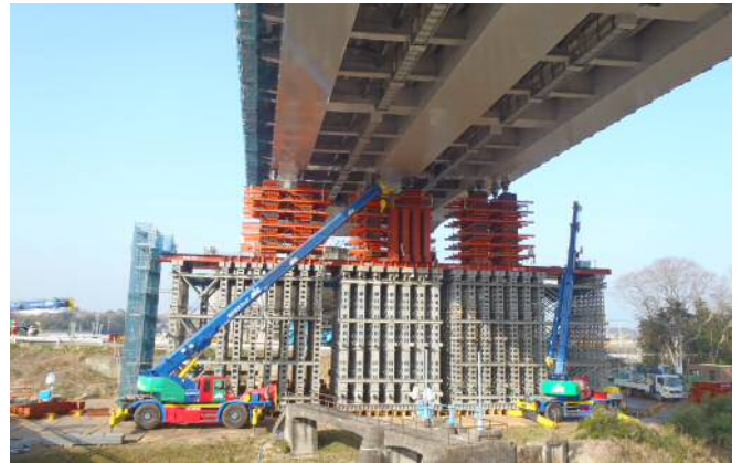
写真-13 BT2降下設備
