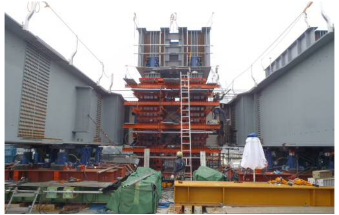
写真-12 BT1降下設備
