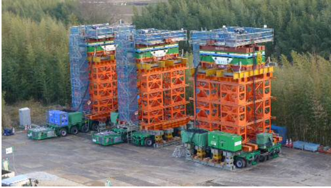
写真－5 一夜ベント設備
