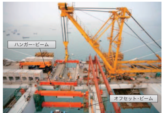
写真-10 閉合用設備
