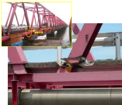
木曾川大橋（1963年竣工）の 斜材破断（2007年）
